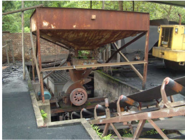
图 1-3 破碎机及配煤机现状图
